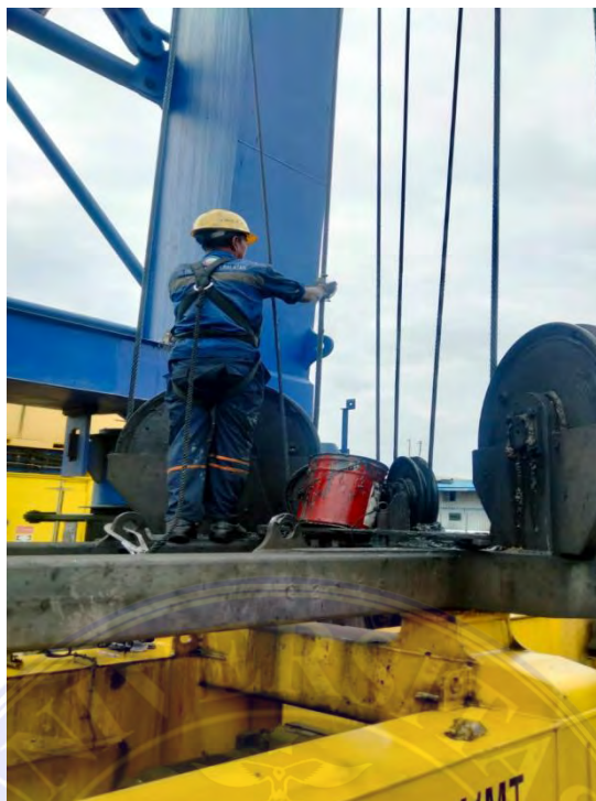
Lampiran 3 proses Pengecekan dan peminyakan Wirerope pada alat kerja Rubber Tyred Gantry Cranes
