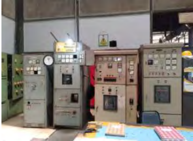
Gambar 3.35. Tenaga Listrik ( PLN )
