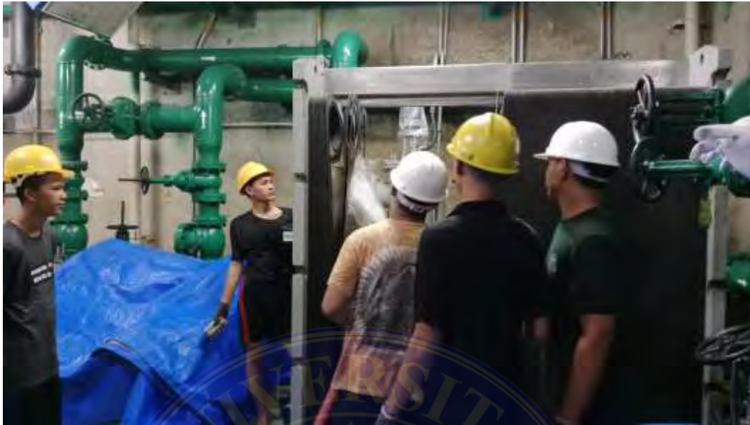
Dokumentasi 3: Maintenance pada HE ( Heat Exchanger )
