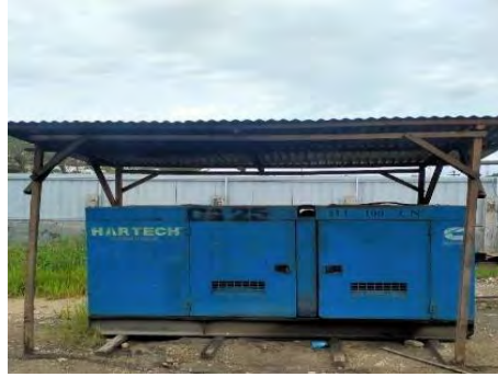
Gambar 3.32 Genset Sumber : Dokumentasi Proyek, 2024
