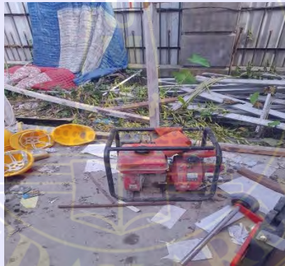
Gambar 3.17 Mesin Pompa Air Sumber : Dokumentasi Proyek, 2024
