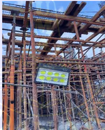
Gambar 3.29 Lampu Penerangan Sumber : Dokumentasi Proyek, 2024
