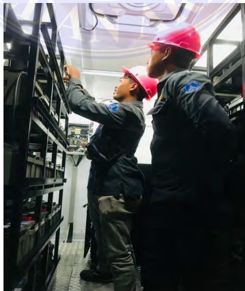
Gambar 6. Instalasi ups sebagai pemasok genset
