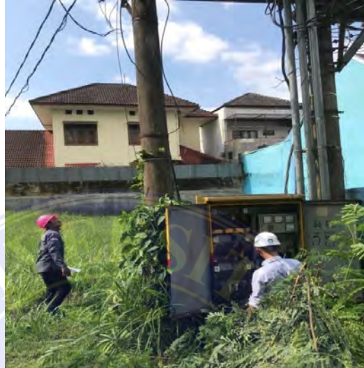
Gambar 3.2 Pengecekan kapasitas trafo
