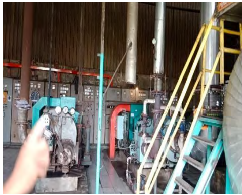
Gambar 18. Stasiun Kamar Mesin (Sumber : Dok. Kelompok, 2024)
