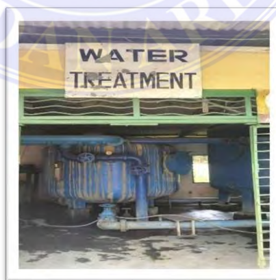
Gambar 19. Water treatment (Sumber : Dok. Kelompok, 2024)
