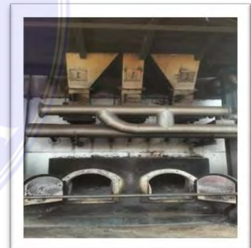
Gambar Stasiun Boiler
