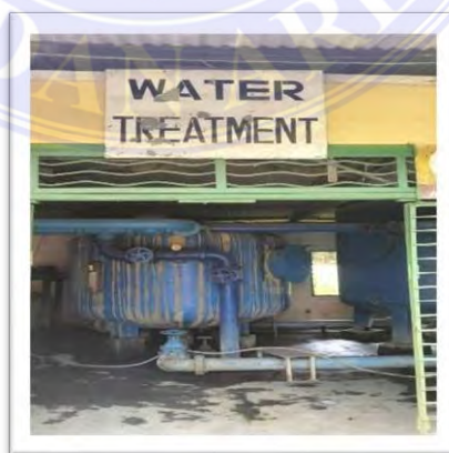
Gambar 19. Water treatment (Sumber : Dok. Kelompok, 2024)
