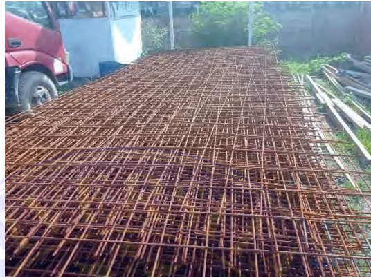
Gambar 3. 41 wiremess Sumber : Dokumen Lapangan
