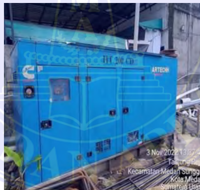
Gambar 3. 11 Genset Sumber : Dokumen Lapangan
