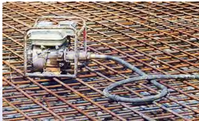
Gambar 2.4 Vibrator Sumber: Data Lapangan 2023
