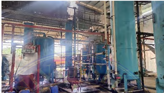
Gambar 3.49 Unit Pengolahan Air
