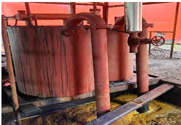
Gambar 3.44 Final Effluent Pit
