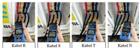
Gambar 4. Pengukuran Tegangan Pada UPS
