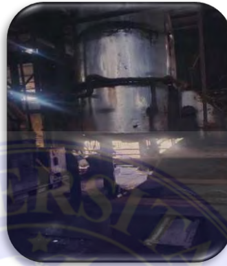
Gambar 14. Digester (Sumber : Dok. Kelompok, 2024)
