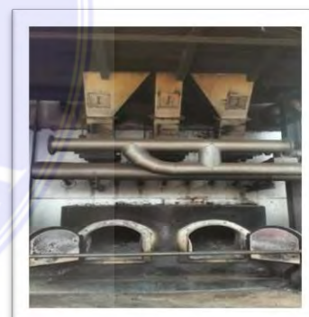
Gambar Stasiun Boiler
