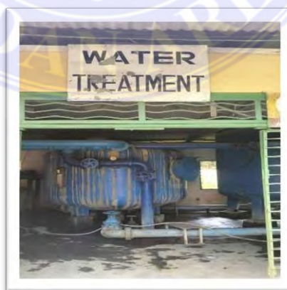
Gambar 19. Water treatment (Sumber : Dok. Kelompok, 2024)
