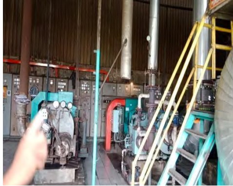
Gambar 18. Stasiun Kamar Mesin (Sumber : Dok. Kelompok, 2024)
