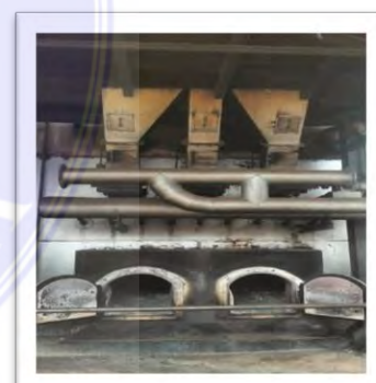
Gambar Stasiun Boiler
