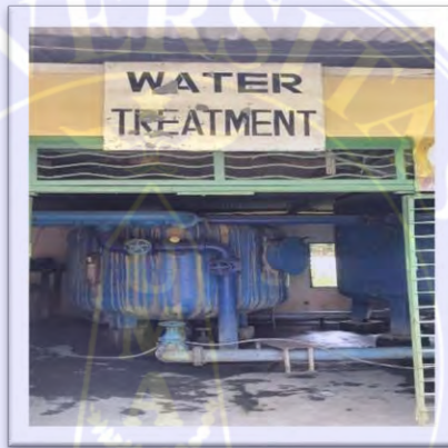
Gambar 19. Water treatment (Sumber : Dok. Kelompok, 2024)
