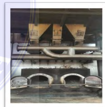
Gambar Stasiun Boiler
