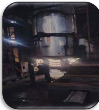
Gambar 14. Digester (Sumber : Dok. Kelompok, 2024)
