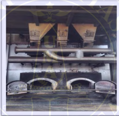
Gambar 17. Stasiun Boiler (Sumber : Dok. Kelompok, 2024)
