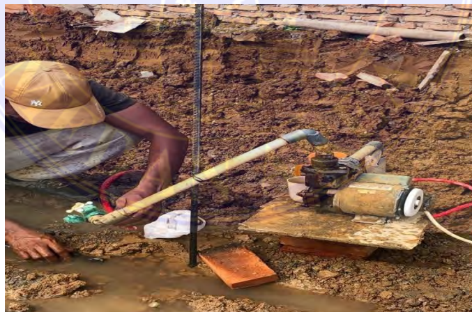
Gambar 3.3. Mesin Pompa Air (Dokumentasi Lapangan, 2025)
