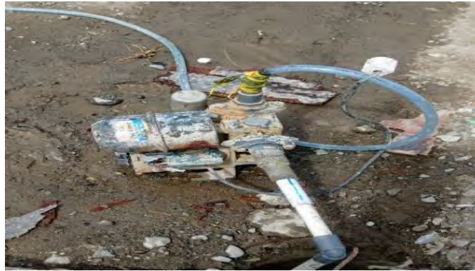
Gambar 3. 11 Pompa Air (Dokumentasi Proyek, 2025)
