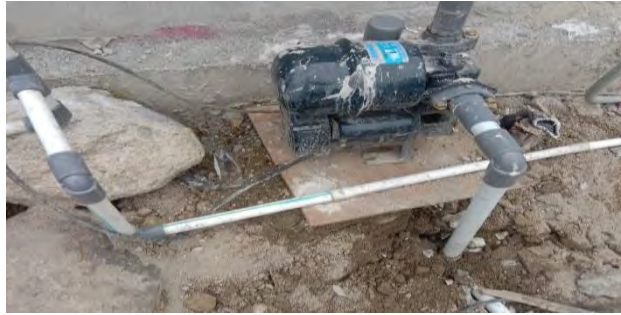
Gambar 3.2. 31 Pompa Air (Dokumentasi Proyek, 2025)
