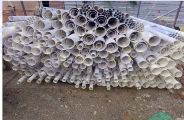
Gambar 3.3 9 Pipa (Dokumentasi Proyek, 2025)
