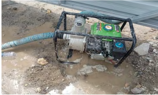
Gambar 3.2. 29 Pompa Penyedot (Dokumentasi Proyek, 2025)
