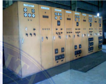
(b) Ruang Kontrol Turbin
