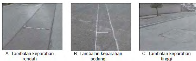
Gambar 12. Tambalan dan Tambalan Galian (Kementerian Pekerjaan Umum dan Perumahan Rakyat, 2016)
