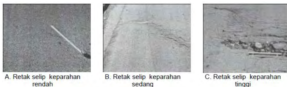
Gambar 18. Retak Selip (Kementerian Pekerjaan Umum dan Perumahan Rakyat, 2016)
