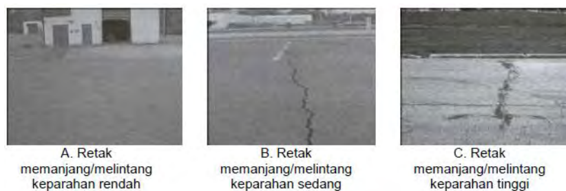
Gambar 11. Retak Memanjang dan Melintang (Kementerian Pekerjaan Umum dan Perumahan Rakyat, 2016)
