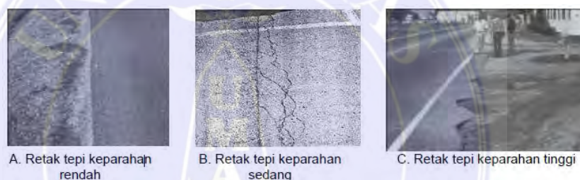
Gambar 8. Retak Tepi (Kementerian Pekerjaan Umum dan Perumahan Rakyat, 2016)
