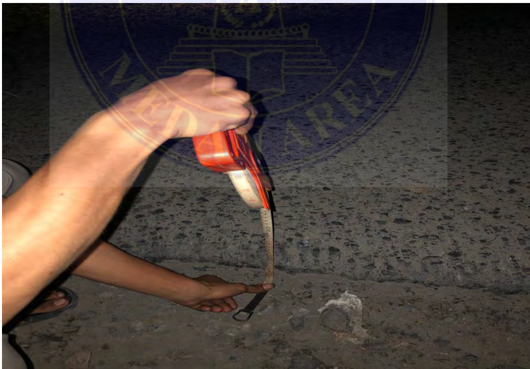
Gambar : Pengukuran dimensi kerusakan pinggiran jalan turun
