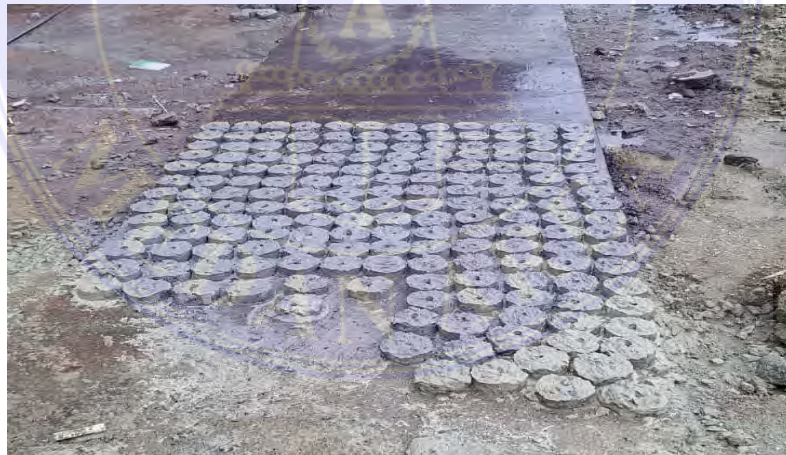
Gambar 14 Spacer beton atau tahu beton (Dokumentasi,2025)
