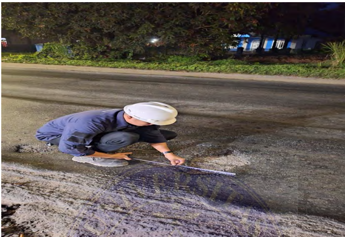
Sedang Mengukur Panjang Kerusakan
