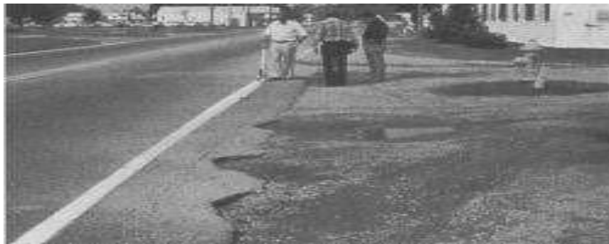
Gambar 4. Retak Pinggir ( edge crack )
