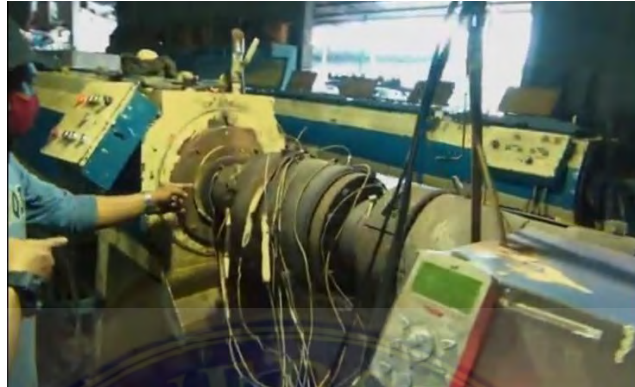
Kabel-kabel pada mesin tidak beraturan
