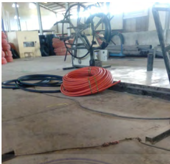
Kabel terbuka dilantai produksi
