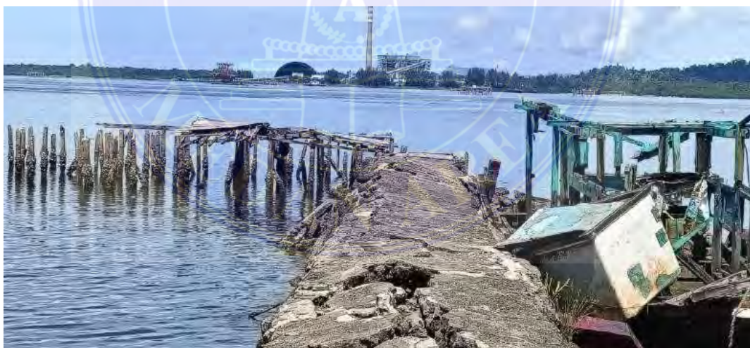
Note : Tambatan Perahu/Dermaga (sudah tidak dipakai/tidak beroperasi)
