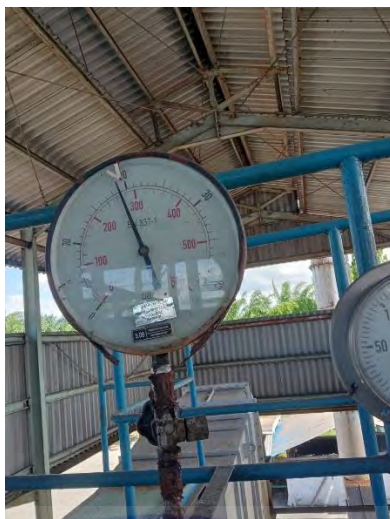
Lampiran 3. Dokumentasi data mentah dari suhu Boiler
