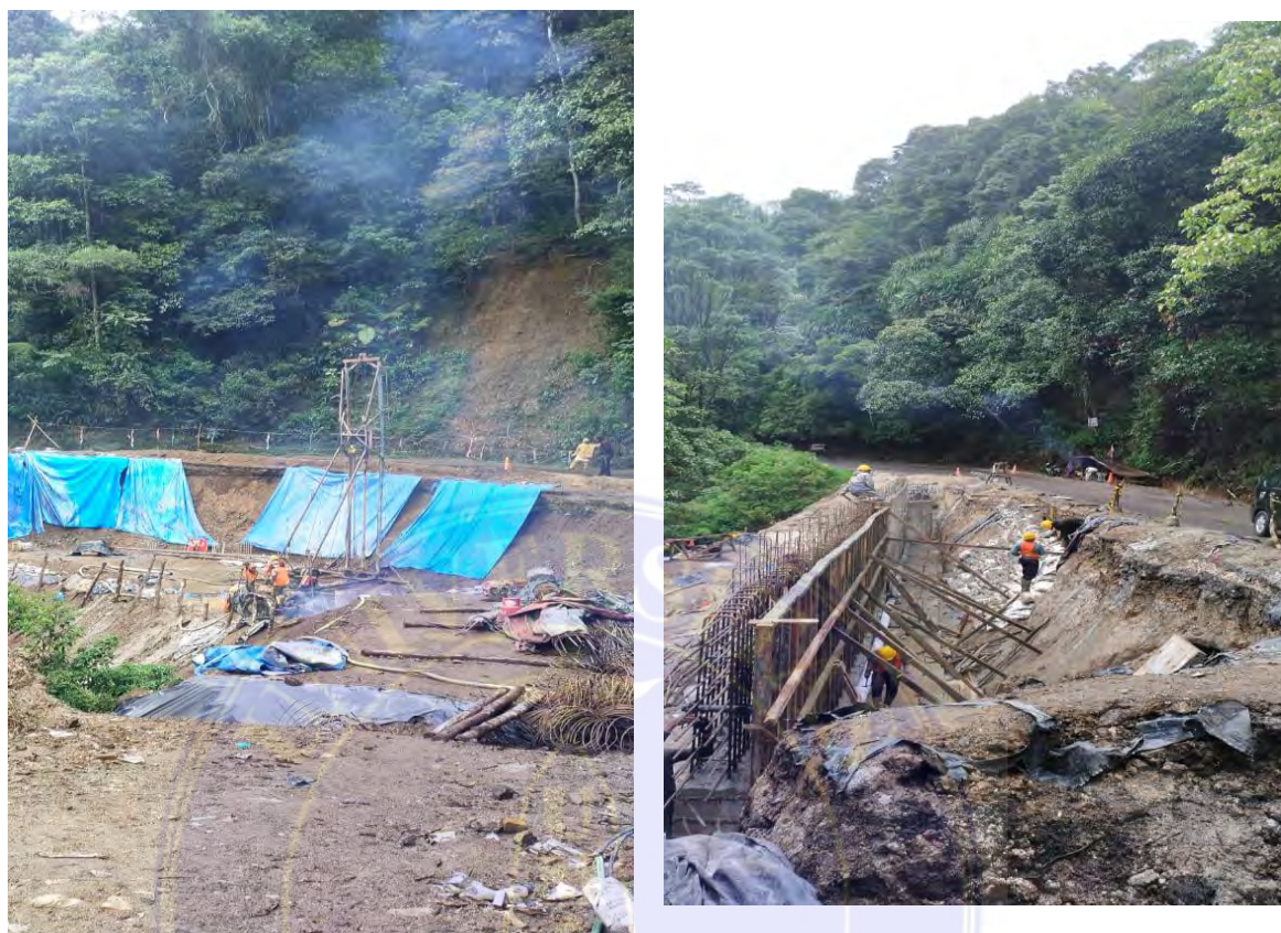
Gambar 1. 4 Foto pada saat berlangsungnya pekerjaan longsoran jalan di jalan Lintas Perapat
