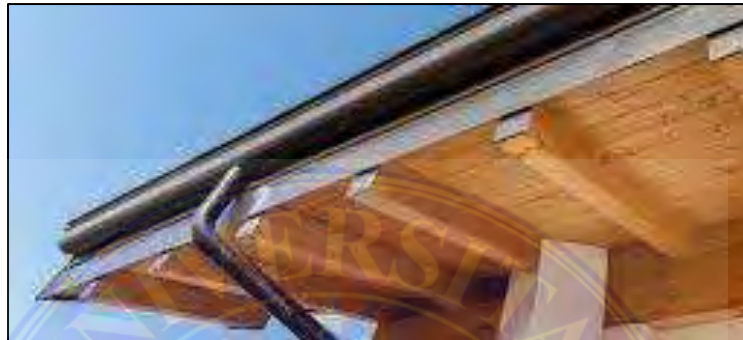
Gambar 2.2 Contoh Teritisan Pada Bangunan Sumber: https://kontraktor-yogyakarta.com
