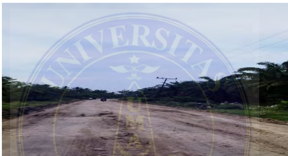
Gambar Kondisi Infrastruktur Jalan di Desa Teluk Pulau Dalam
