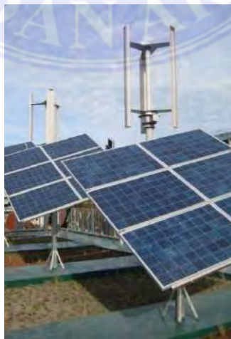
Gambar 2.29 Panel Surya Fotovoltaik pada Pixel Building
