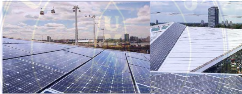
Gambar 2.25 Panel surya fotovoltaik pada atap The Crystal
