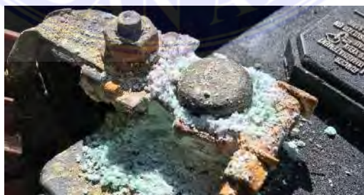
Gambar 2.2: Elektroda Baterai dengan Kristal Sulfat yang Terbentuk (Sumber: https://fastnlow.net/cara-mudah-mengatasi-korosi-pada-terminal-aki/ )
