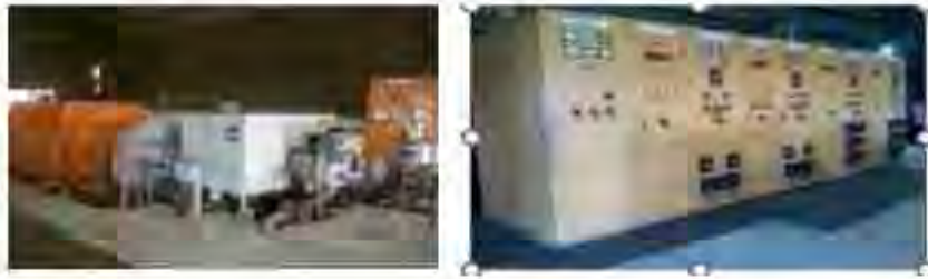
Gambar 3.17. Stasiun Pembangkit Tenaga Uap
