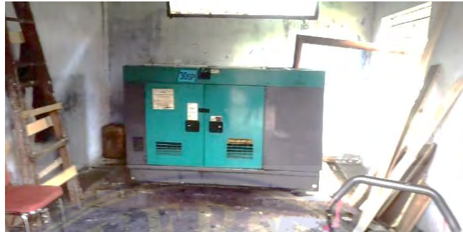
Gambar 2.1 Generator Set Kantor BASARNAS Medan
