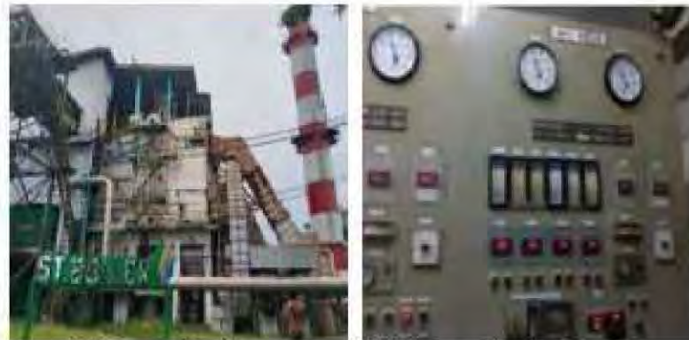
(a) Stasiun boiler
