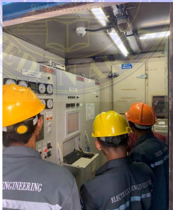
Gambar 3.1 pengecekan sistem kontrol
