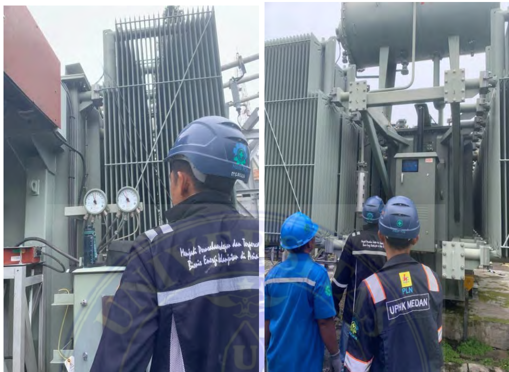
Gambar 1. Pemeliharaan trafo transmisi
