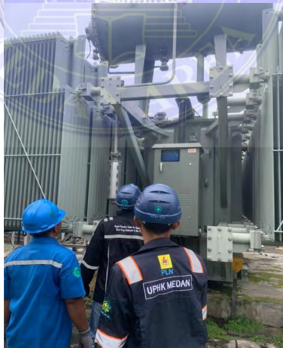
Gambar 2.1 pemeliharaan trafo transmisi
