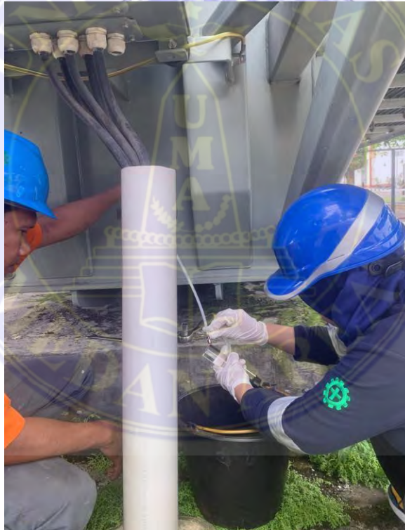
Gambar 2.3 Pengecekan minyak trafo
