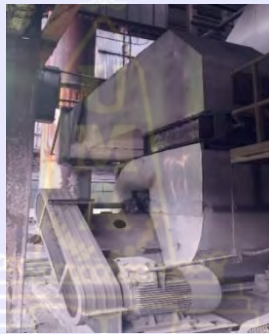
Gambar 3. 33 Bentuk Induced Draft Fan
