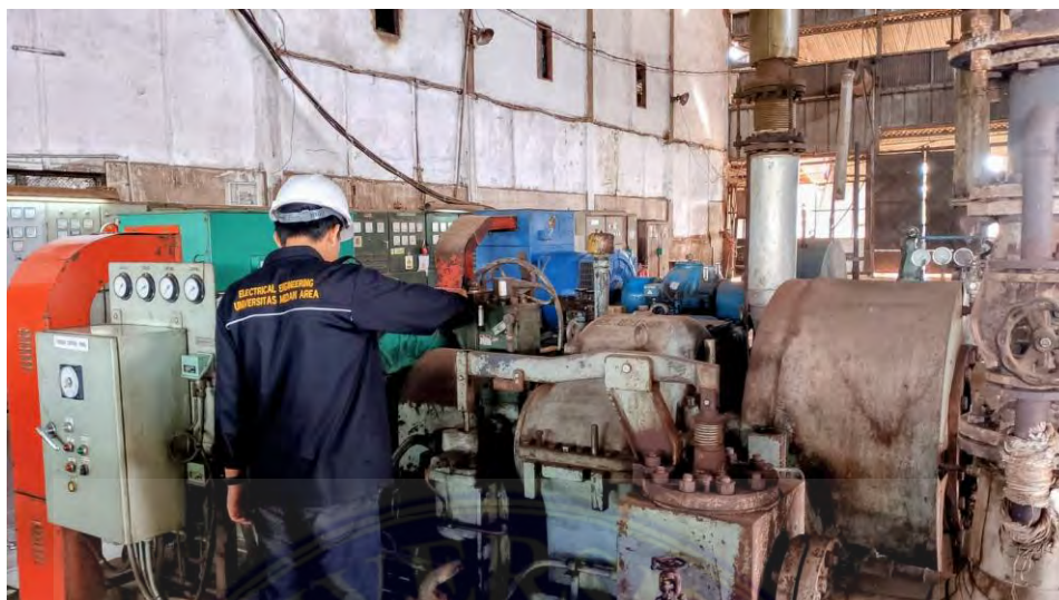
Pengecekan Komponen Turbin Uap
