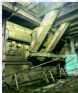
Gambar 3. 30 Bentuk Stasiun Boiler
