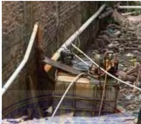
Gambar 3.16 Mesin Pompa Air (Dokumentasi Proyek)
