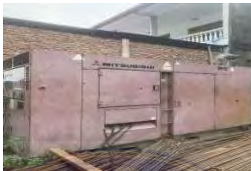
Gambar 3.31 Genset (Dokumentasi Proyek)
