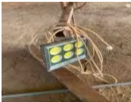
Gambar 3.28 Lampu Penerangan (Dokumentasi Proyek)
