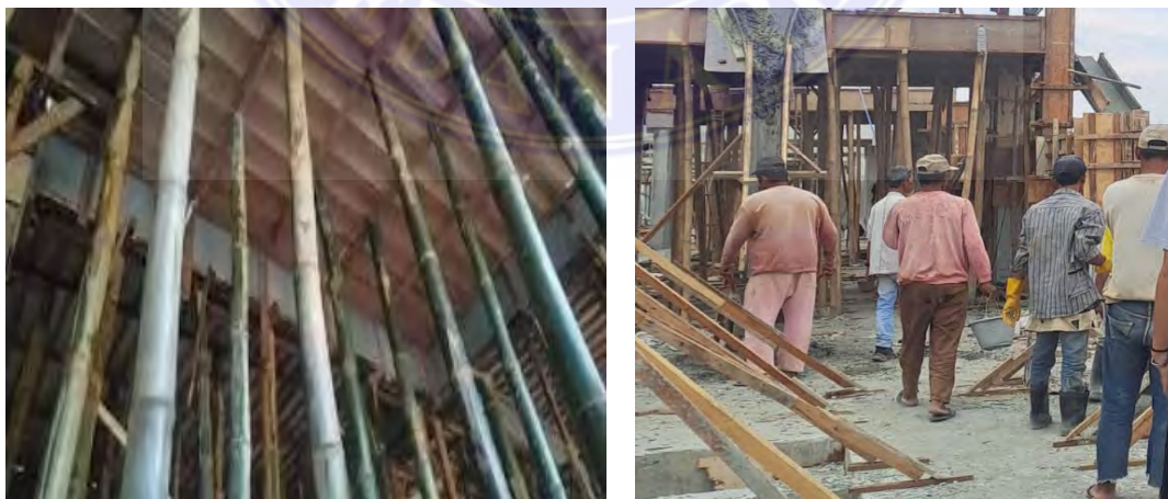
Gambar No.6 Proses Pelepasan Perancah dan Bekisting Setelah Beton Mencapai Kekuatan Yang Cukup
