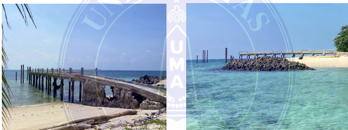
Gambar13. Bangunan yang tidak selesai di Pulau Pandang
