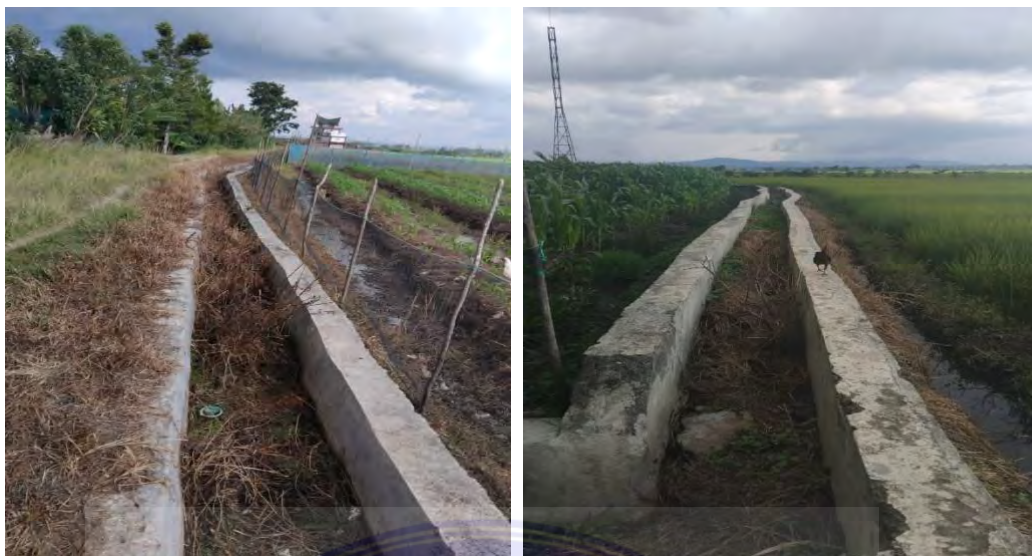
Gambar Kondisi Saluran Irigasi Pertanian yang Mengalami Kerusakan dan Kurang Perawatan di Desa Aeknauli-II
