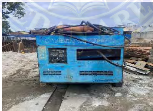
Gambar 3.11 Compressor (Dokumentasi Proyek, 2025)
