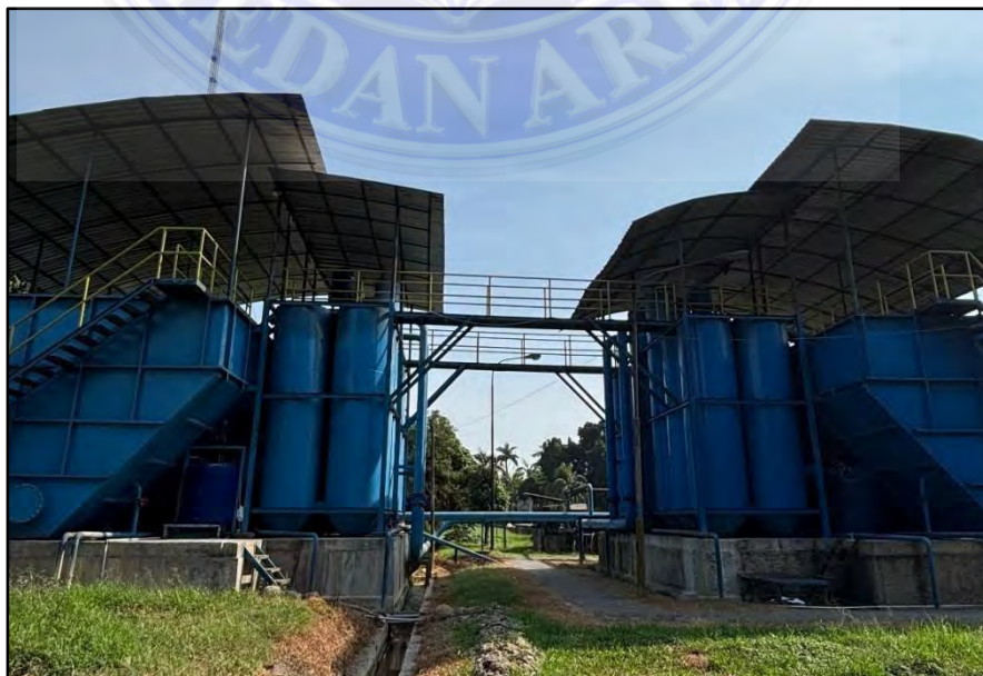
Gambar 3.33 Stasiun Pengolahan Air ( Water Treatment )
