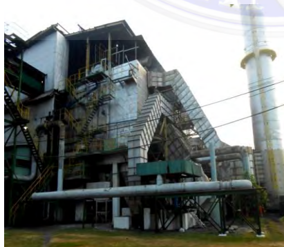
(a) Stasiun Boiler
