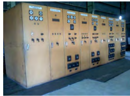
(b) Ruang Kontrol Turbin
