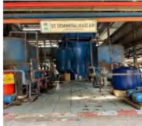
Gambar 3.51 Stasiun Water Treatment
