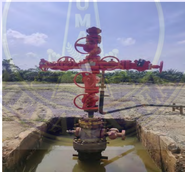
Gambar 3. 3 Wellhead dan Christmas Tree
