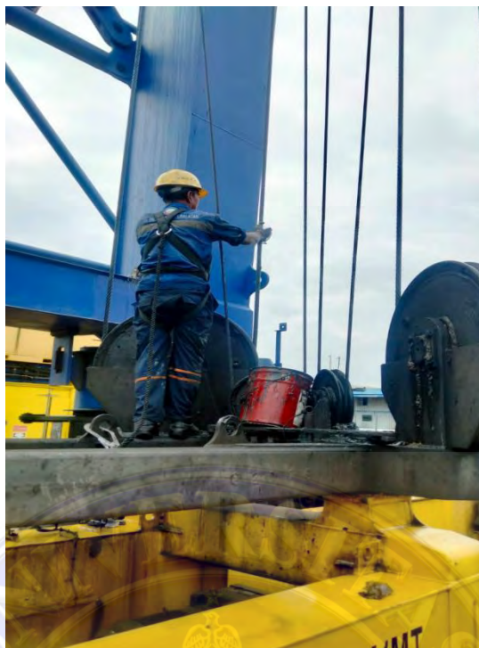
Lampiran 3. proses Pengecekan dan peminyakan Wirerope pada alat kerja Rubber Tyred Gantry Craner
