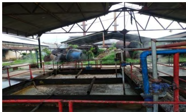
Gambar 3.32. Bak Penampung Sludge ( Fat Fit )
