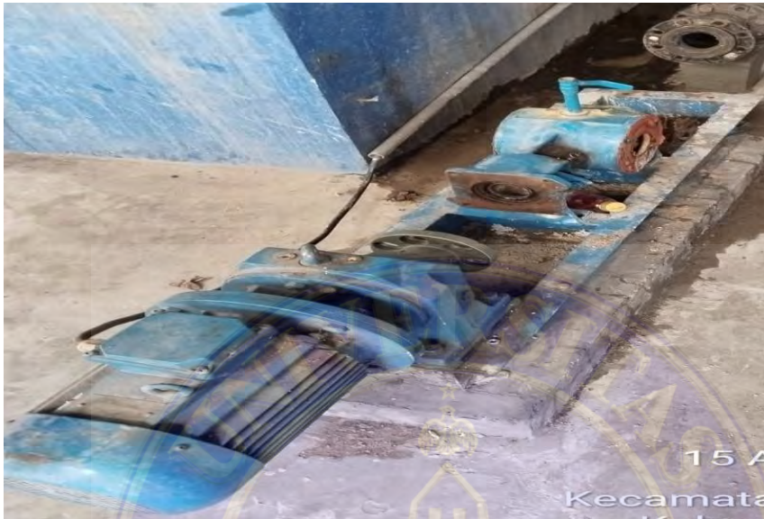
Gambar 2.1 Pompa Air di IPLT
