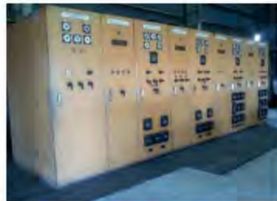
(b) Ruang Kontrol Turbin
