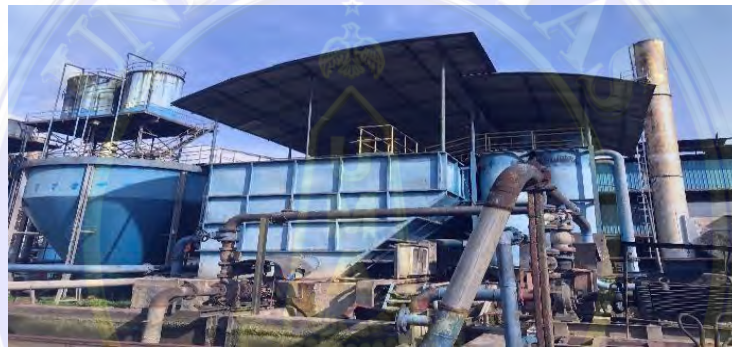
Gambar 3. 33 Stasiun Pengolahan Air (Water Treatment)
