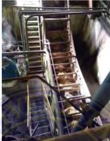
Gambar 3.7 Elevator Ampas Tebu Ke Boiler
