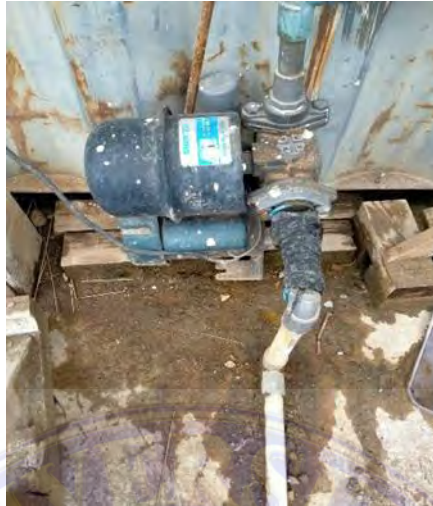
Gambar 3.6 Pompa Air (Dokumentasi Proyek, 2026)
